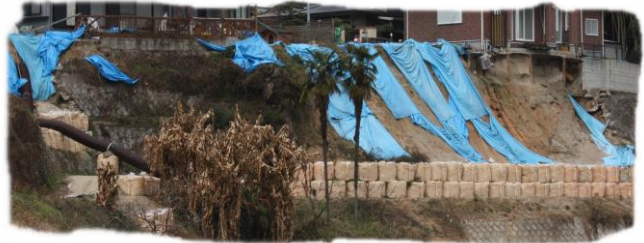
九州地区の豪雨での擁壁の倒壊事例
